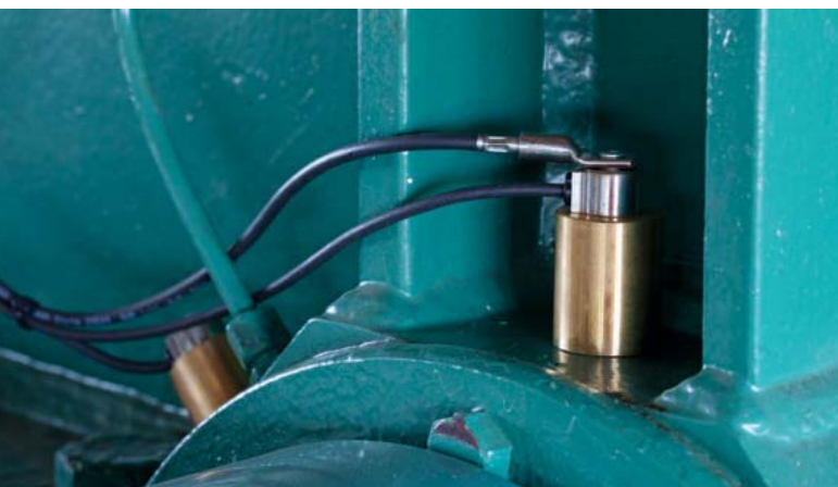
Je zwei versetzt angebrachte Schwingungssensoren überwachen permanent den Zustand der rotierenden Lager.
