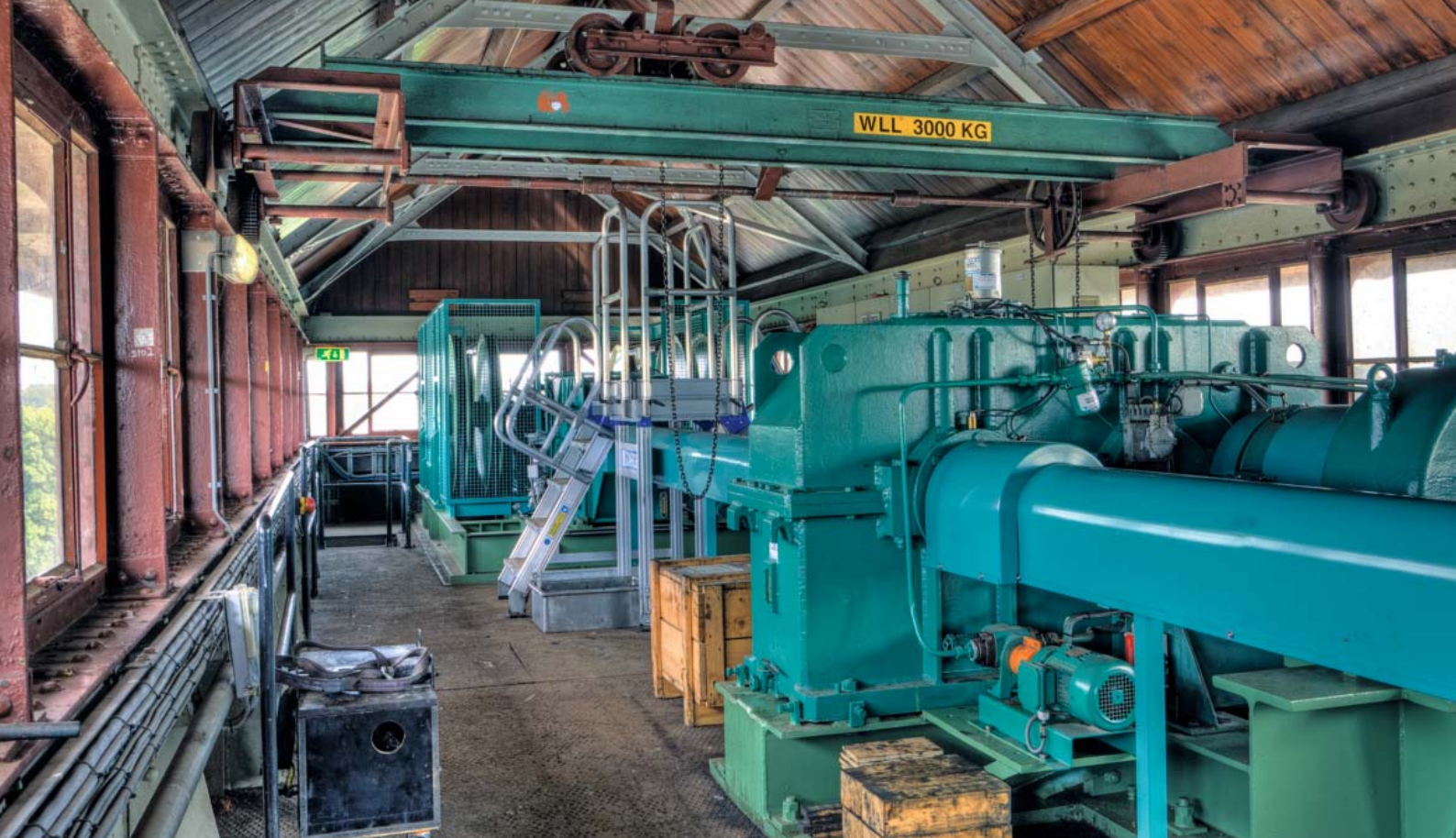
Der Antriebsstrang zum Heben und Senken der schweren Schleusentore. Die Zustände von Motoren, Wellen und Getrieben werden permanent mittels Schwingungsdiagnose überwacht.
