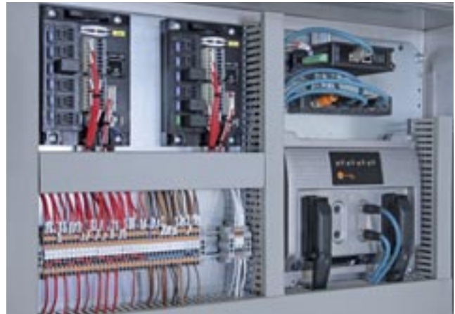
Die zentrale mobiltaugliche Steuerung ecomatController von ifm (rechts unten montiert) ist im Schaltschrank im Außenbereich des Fahrzeugs montiert.
