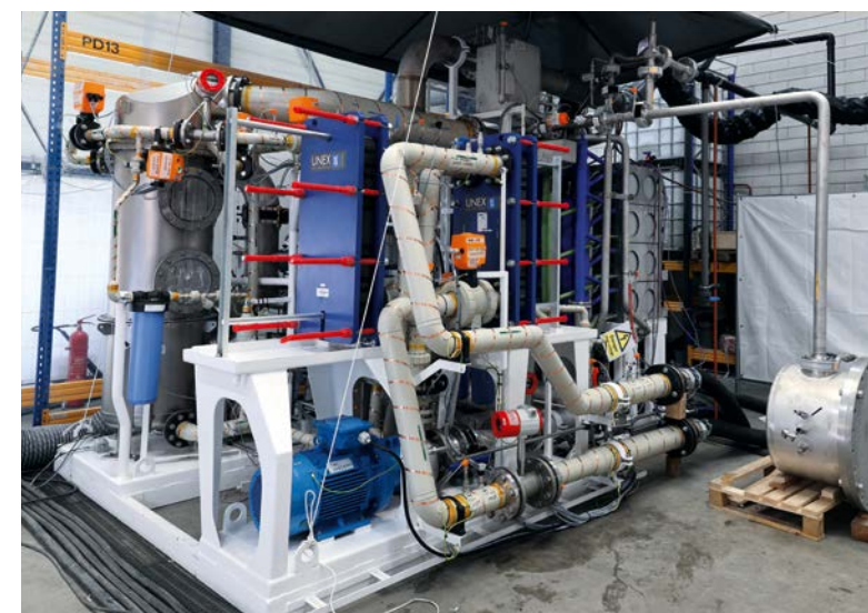
Le système de propulsion à l'hydrogène K2 développé par Koedood et Kooiman est testé avant d'être installé.
