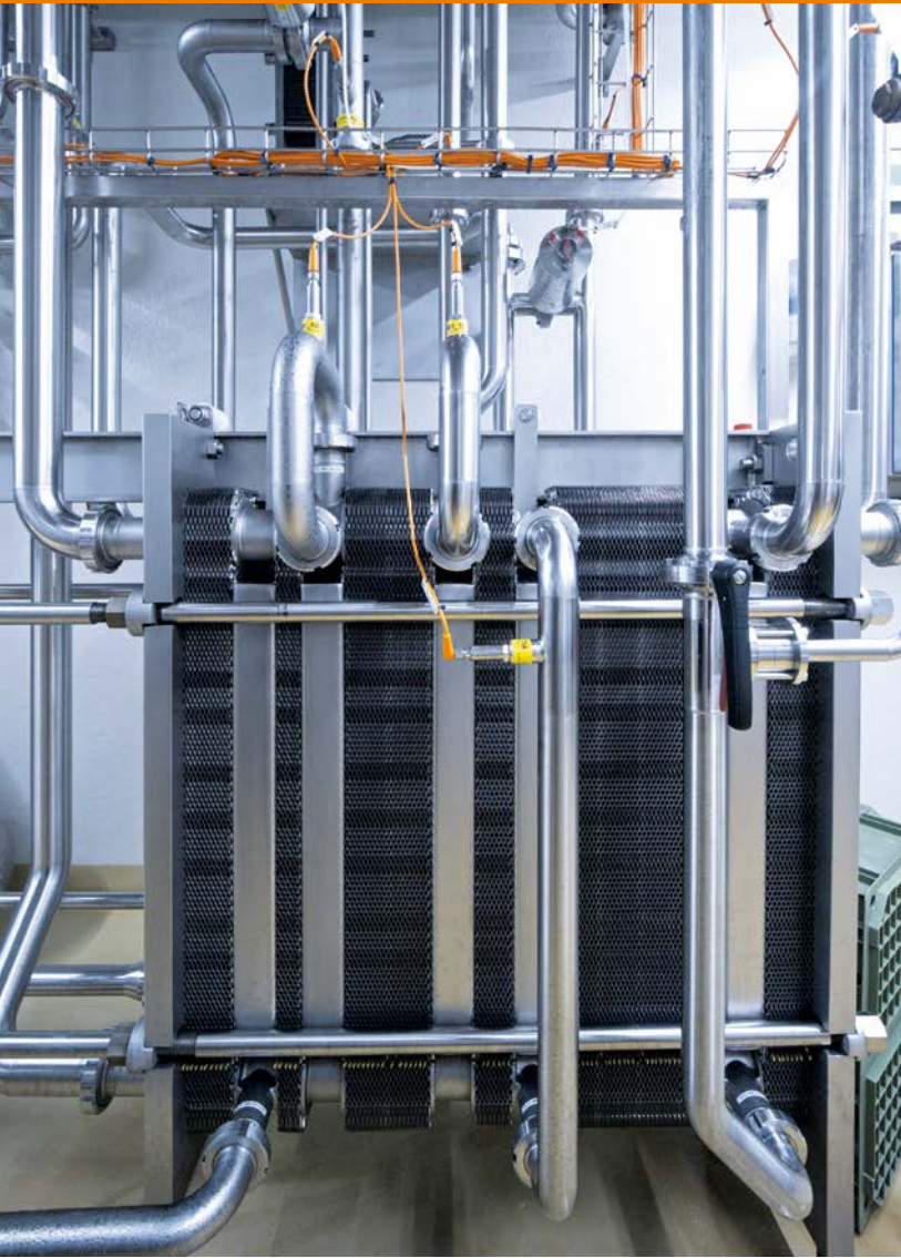
Herzstück der Anlage: Plattenwärmetauscher zum exakten Temperieren der Rohmilch.
