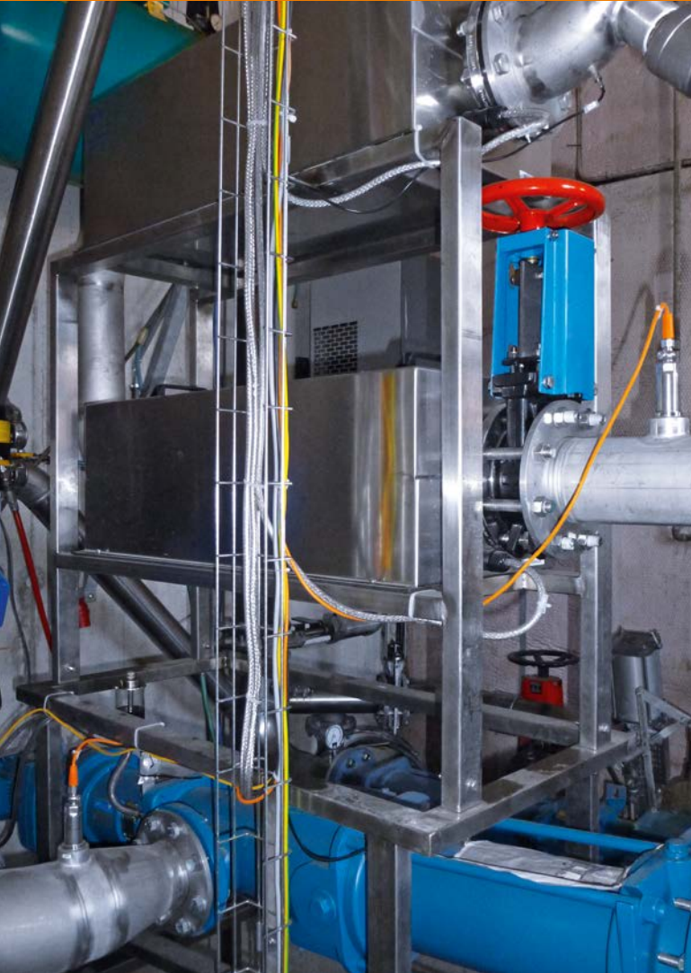
In der Ultraschall-desintegrationsanlage wird Biomasse für eine maximale Energieausbeute aufbereitet.
