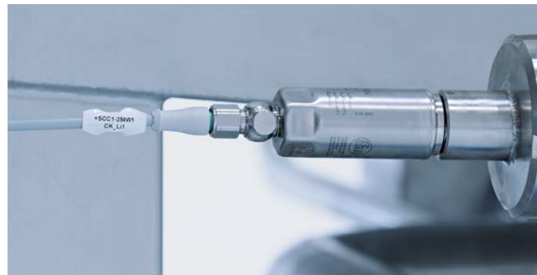
Unterschiedlichste Sensoren überwachen Drücke, Temperaturen und Positionen in der Anlage.
