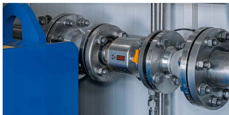
Zentraler Messwert: Ein magnetisch-induktiver Durchflusssensor überwacht die Klärschlammmenge, die in die Zentrifuge gelangt.
