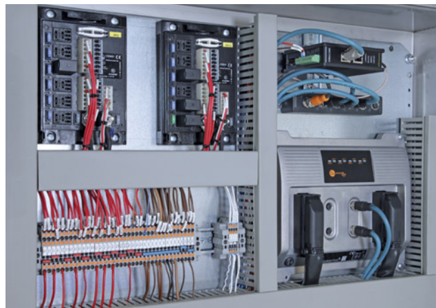
O controlador ecomatController da ifm para aplicações móveis (parte inferior direita) é montado no quadro de distribuição na área externa do veículo.
