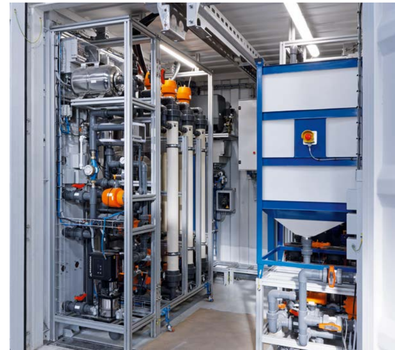
La instalación completa de tratamiento del agua está integrada en un contenedor compacto.
