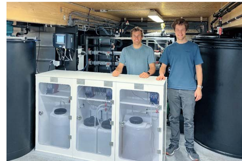
Nicolas Herinckx (a sinistra) e Aymar de Lichtervelde (a destra), ingegneri della stazione di ricerca Princess Elisabeth, davanti al nuovo impianto di trattamento dell'aria: Prestazioni elevate e affidabili anche in spazi ridottissimi.
