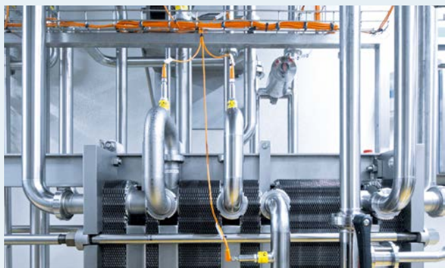
チーズ工場の心臓部：生乳の温度を正確に管理するためのプレート式熱交換器
