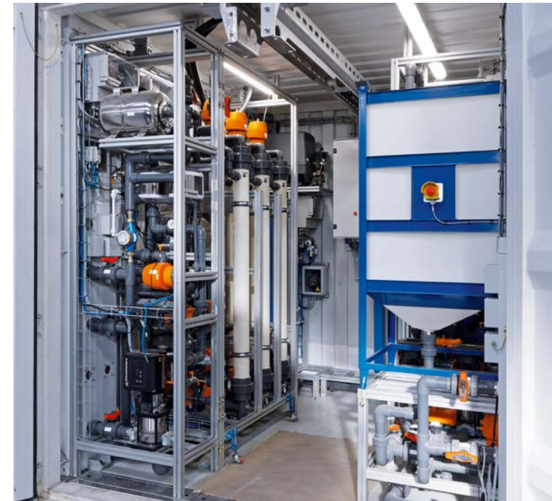
L'ensemble du traitement de l'eau est intégré dans un conteneur compact.
