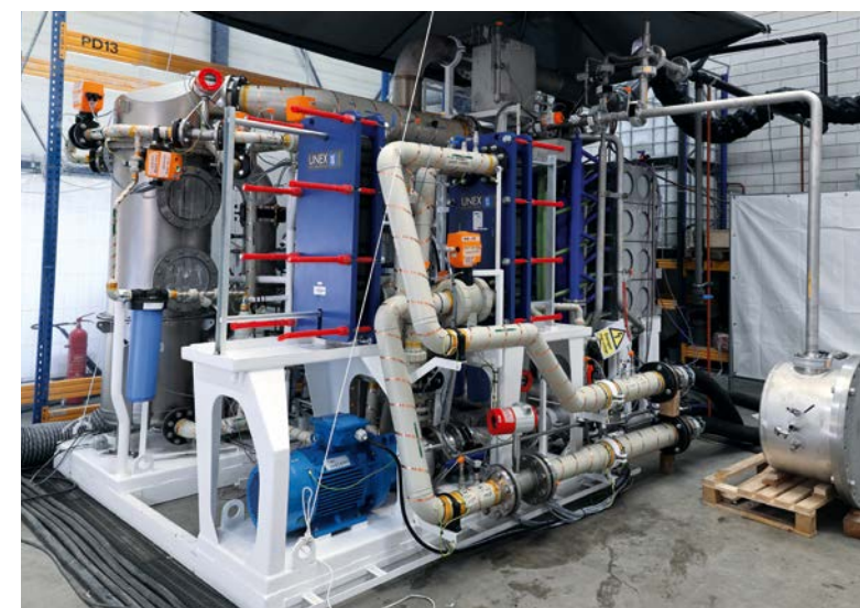
O sistema de propulsão a hidrogênio K2 desenvolvido pela Koedood e Koimaan é testado da instalação.
