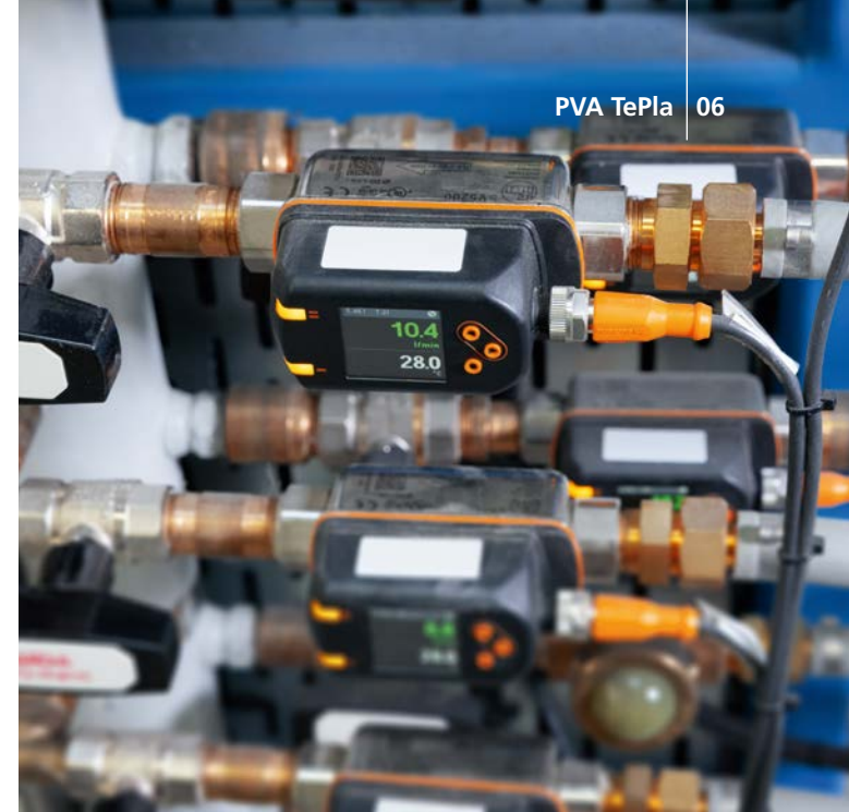
Fácil lectura: caudalímetros en una instalación de unión por difusión.
