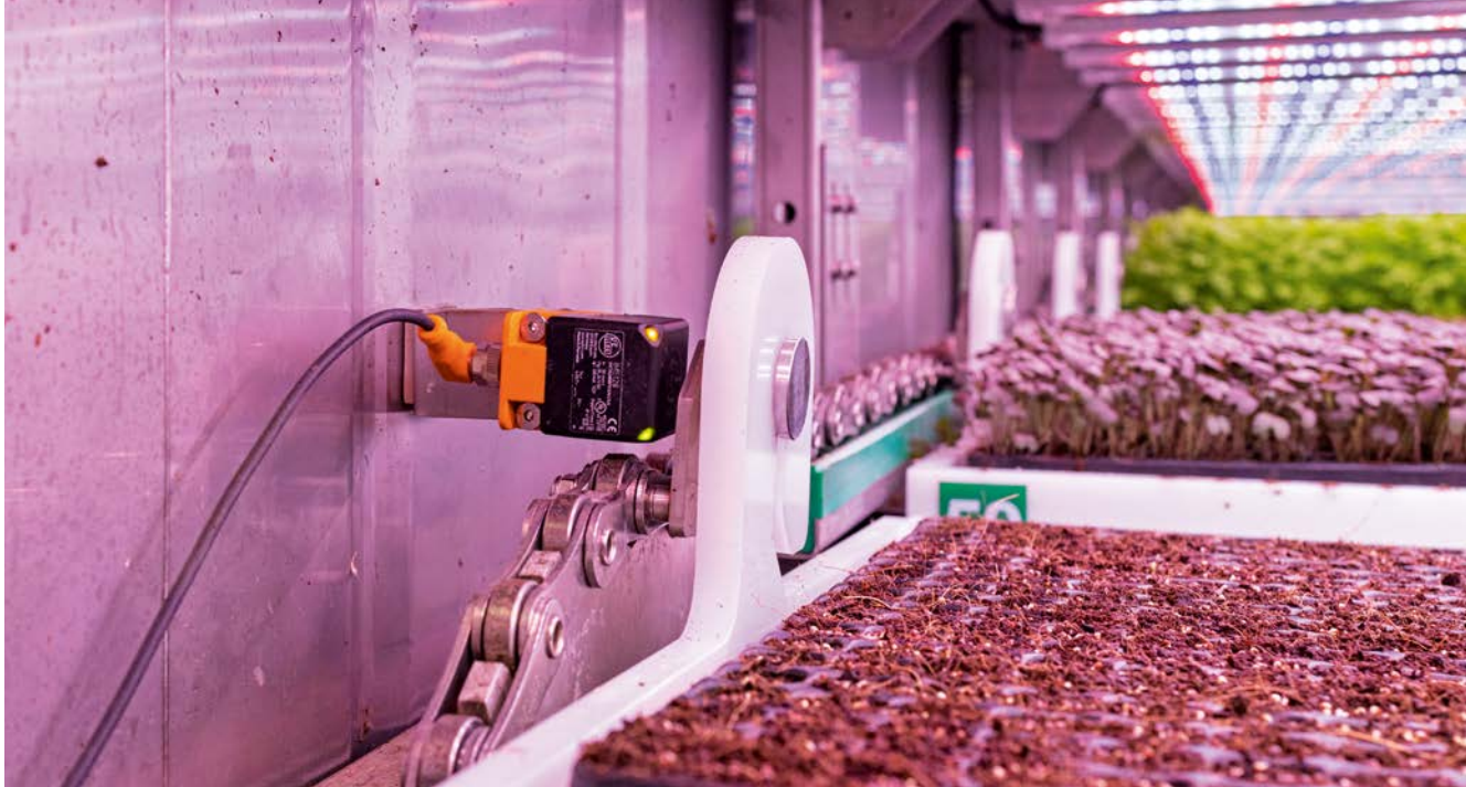
Induktive Sensoren von ifm sorgen für einen sicheren Ablauf der Transportprozesse im ModuleX.
