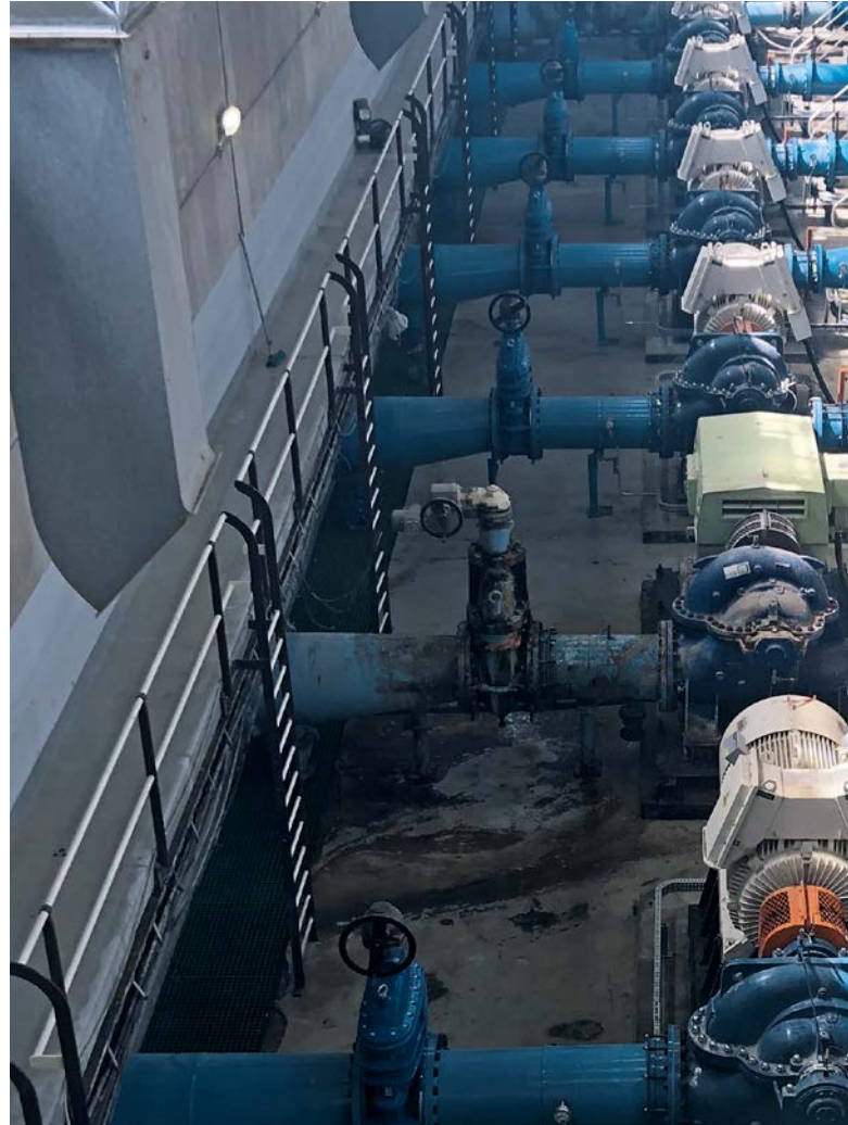
Midvaal Water의 high-lift 펌프 스테이션 5개의 최신 모터 펌프 세트 (회색 모터 하우징)에는 IO-Link 센서 및 상태 모니터링 솔루션이 장착되어 있습니다.
