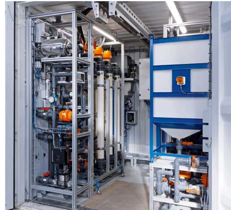
O tratamento de água completo está integrado em um container compacto.
