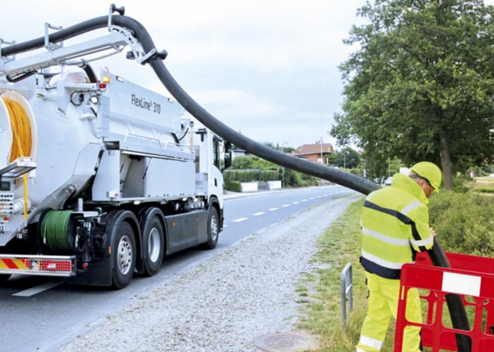
Kanalreinigungsfahrzeug mit Spül- und Saugpumpe zur Reinigung von Abwasserkanälen.
