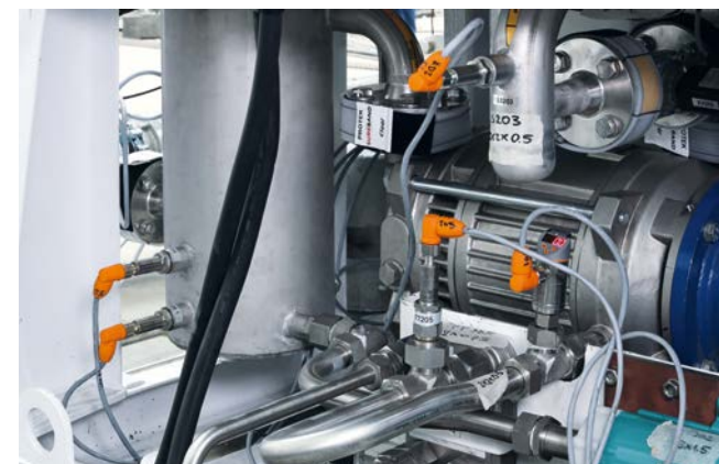
Mit einer Vielzahl an Sensoren wird der komplexe Prozess engmaschig überwacht, um den bestmöglichen Wirkungsgrad zu erzielen.
