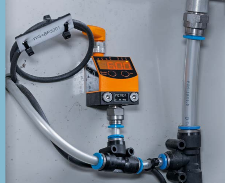
Un sensore di pressione PQ monitora l’aria compressa necessaria per la commutazione delle valvole.
